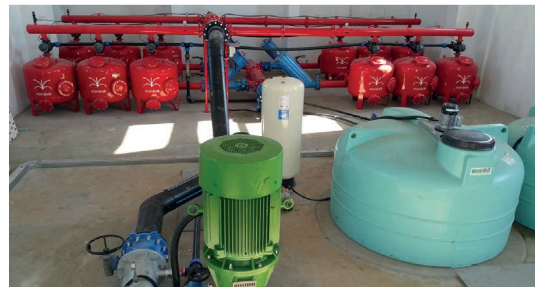
Stazione di fertirrigazione e filtrazione
